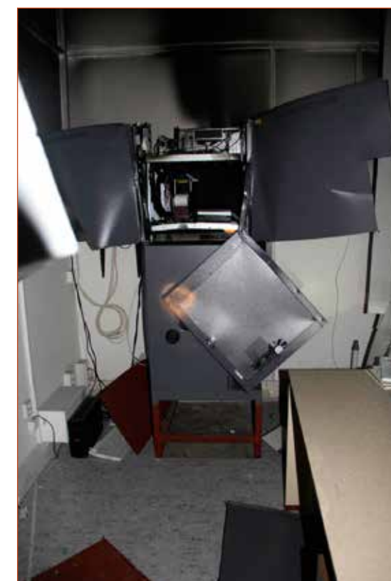
Obr. č. 4 – Zadní část bankomatu při pohledu z technické místnosti.
