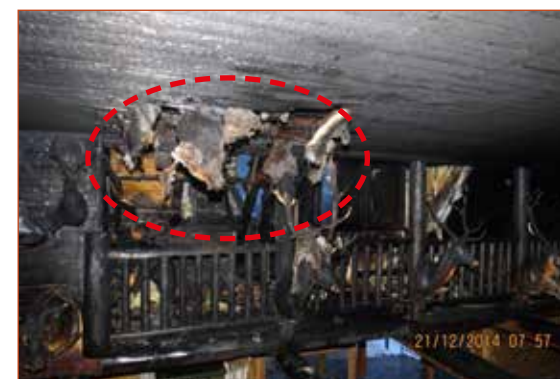
Obr. č. 3 – Požární ohnisko.
