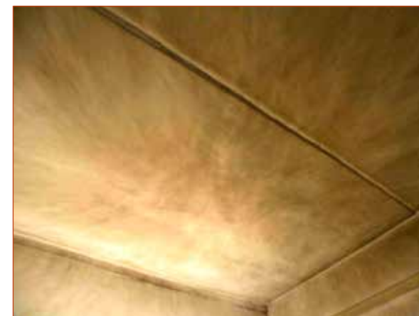
Obr. č. 3 – Stopy po explozivním hoření par hořlavých kapalin I. třídy nebezpečnosti.
