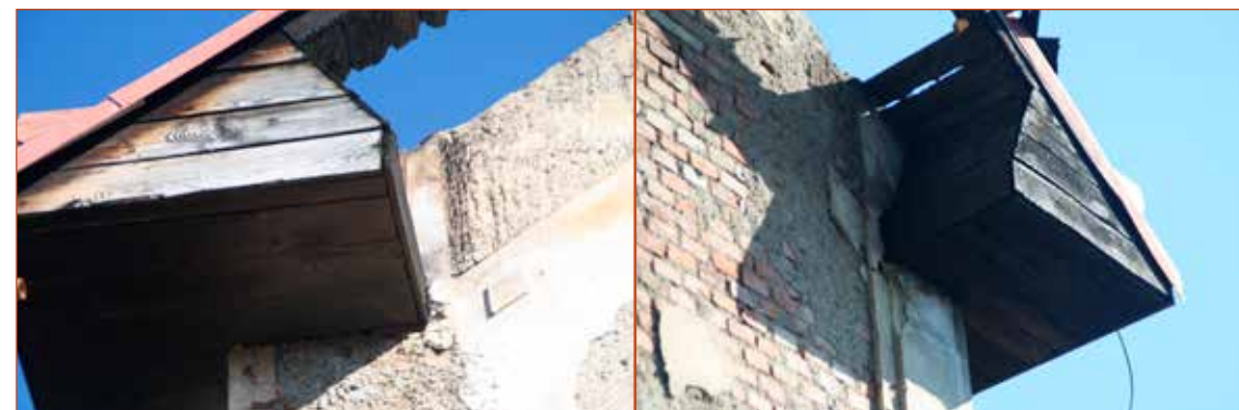
Obr. č. 3 – Bednění kolem pozednice u okapnice štítu nad kůlnou vlevo. Pozednice uvnitř je ohořelá do hloubky materiálu, bednění pouze na povrchu (viz obr. 6).
