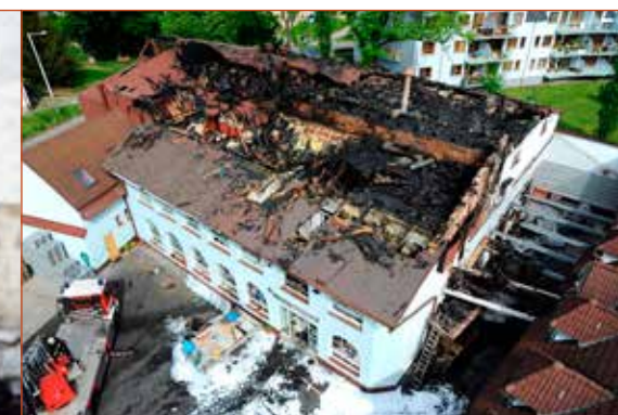
Obr. č. 7 – Následky požáru.
