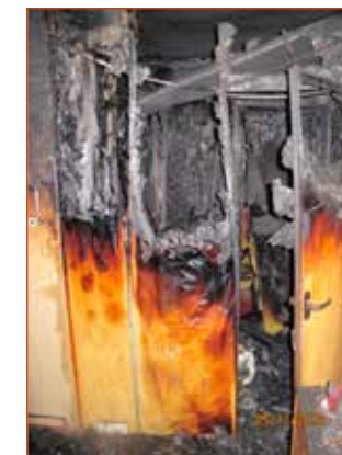
Obr. č. 4 – Pohled na vyhořelé bytové jádro jednoho z bytů ve vyšších podlažích domu.
