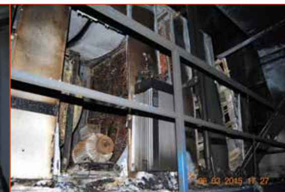
Obr. č. 4 – Vzduchotechnické zařízení GEA (kriminalistické ohnisko).
