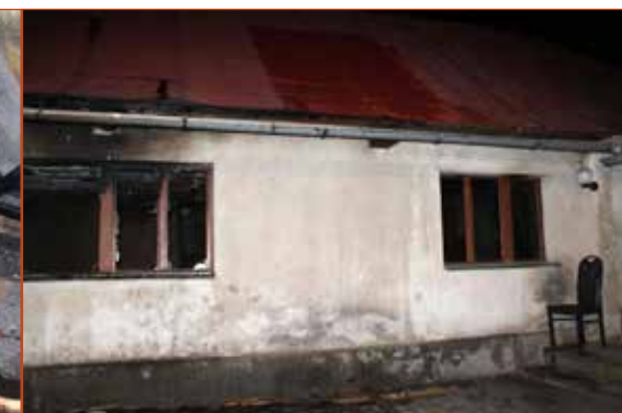
Obr. č. 4 – Celkový pohled (2. požár).
