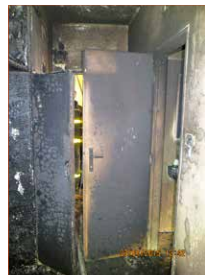
Obr. č. 5 – Předsíň po požáru.
