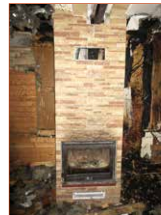
Obr. č. 3 – Detailní pohled na obezděnou krbovou vložku – iniciátor požáru.
