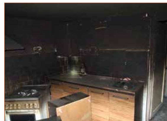
Obr. č. 5 – Zasažený vnitřek domu (2. požár).
