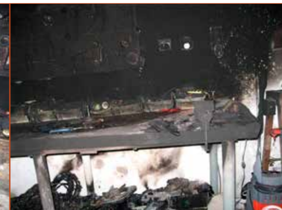
Obr. č. 3 – Zásuvka na 230 V těsně po požáru.
