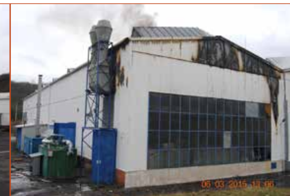
Obr. č. 2 – Výrobní hala č. 7 s lisovnou plastových dílů (požární ohnisko).
