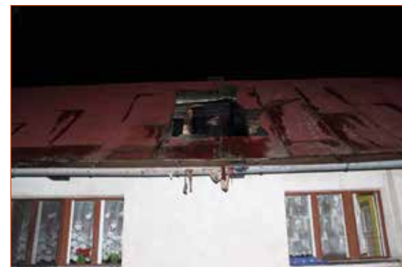
Obr. č. 1 – Celkový pohled (1. požár).
