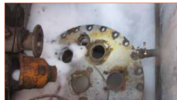
Obr. č. 3 – Pohled na armatury do šachty, kde došlo k výbuchu.
