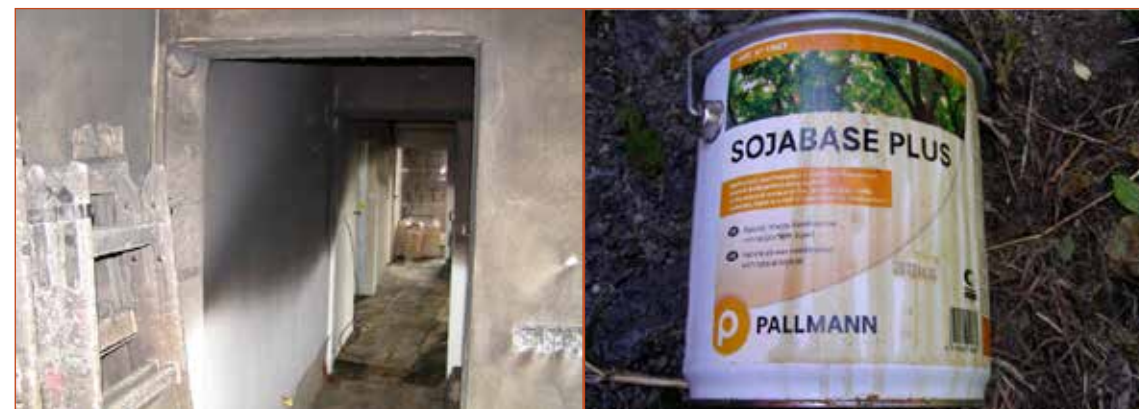
Obr. č. 5 – Pohled z garáže do chodby (směr šíření požáru).
