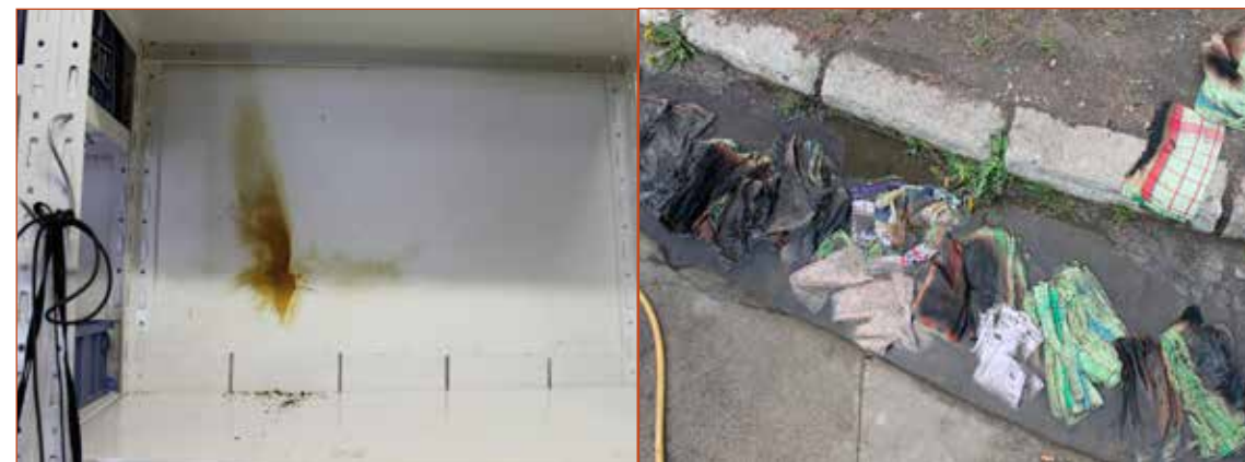
Obr. č. 3 – Bližší pohled na stopu po požáru.
