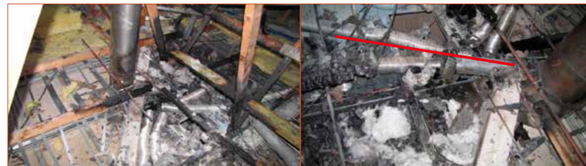
Obr. č. 1 – Místo požáru, dvojitý, odizolovaný, nerezový kouřovod vsunutý do kobky i s vnějším pláštěm.
