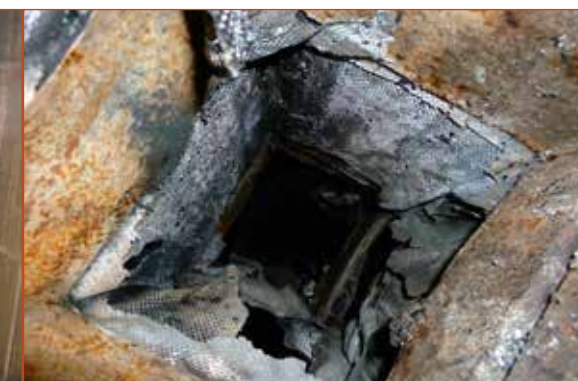
Obr. č. 6 – Ventilační systém obdélníkového průřezu (svislé ventilační tahy), který je vyroben z polyesterového skelného laminátu.
