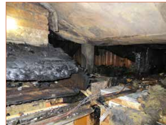
Obr. č. 4 – Detailní pohled na poškozenou střešní konstrukci nad stanoveným kriminalistickým ohniskem.
