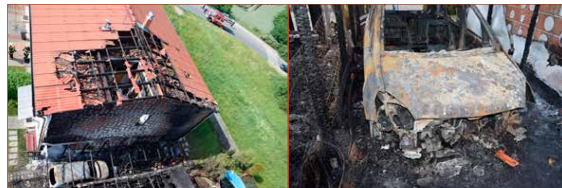
Obr. č. 3 – Pohled na propadlou SDK konstrukci.
