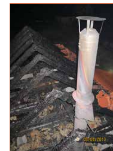
Obr. č. 6 – Pohled na okolí systémového komína – kriminalistické ohnisko.
