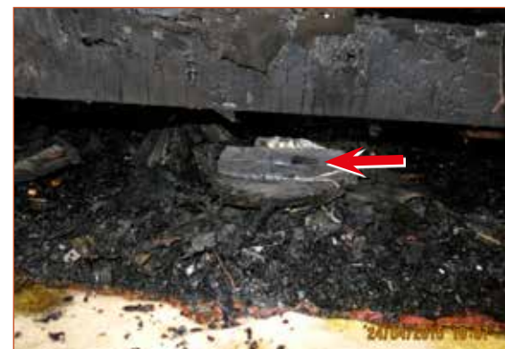
Obr. č. 5 – Pohled na vyhořelý napájecí Li-Pol zdroj spadlý na podlahu po prohoření pohovky.
