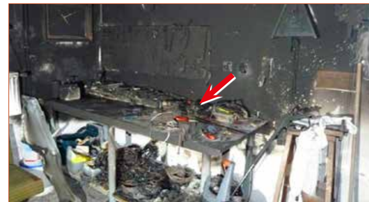
Obr. č. 1 – Poškozená dílna a pracovní stůl.
