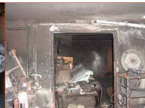
Obr. č. 5 – Pohled na stav poškození garáže RD.
