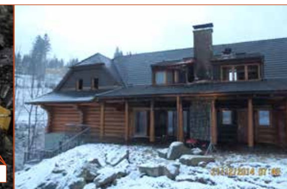
Obr. č. 6 – Pohled na prohoření střešního pláště z vnější strany.
