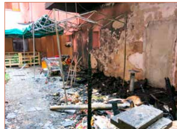
Obr. č. 3 – Pohled na místo vzniku požáru (místo uložení dřevěných bedýnek od jahod).
