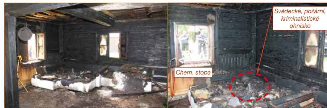
Obr. č. 3 – Pohled do obývacího pokoje, místo vzniku požáru.
