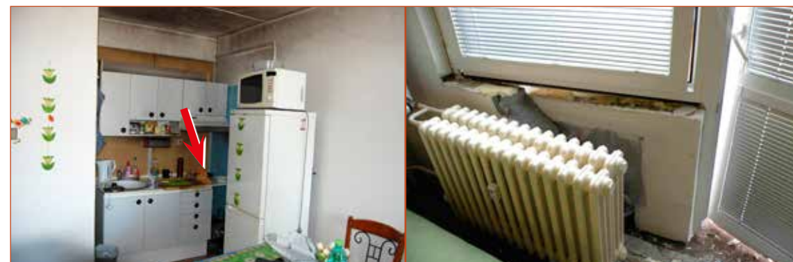
Obr. č. 1 – Místo vzniku požáru.
