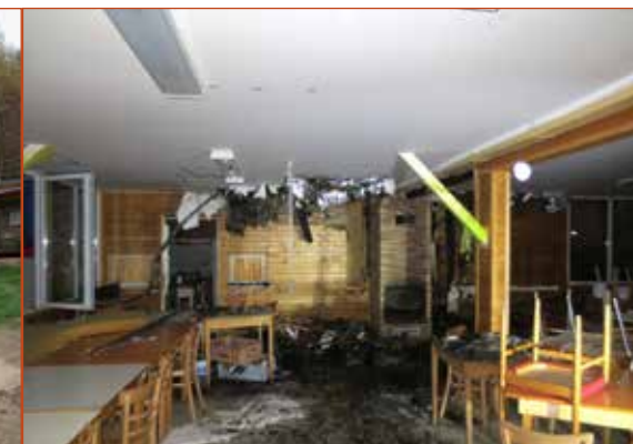
Obr. č. 2 – Pohled uvnitř jídelny na místo požáru.
