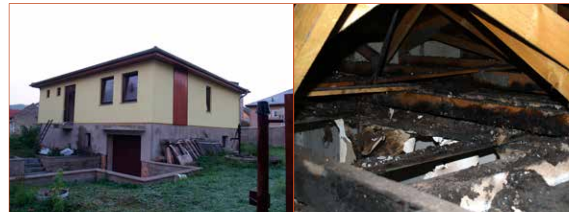
Obr. č. 1 – Celkový pohled na požárem zasaženým rodinným domem.
