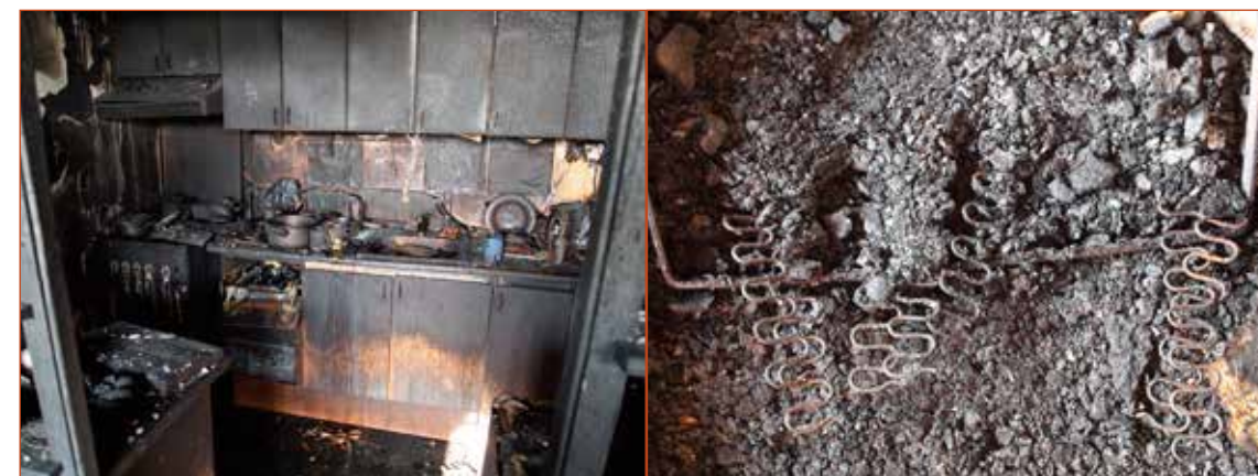
Obr. č. 4 – Požárem poškozená kuchyňská linka.
