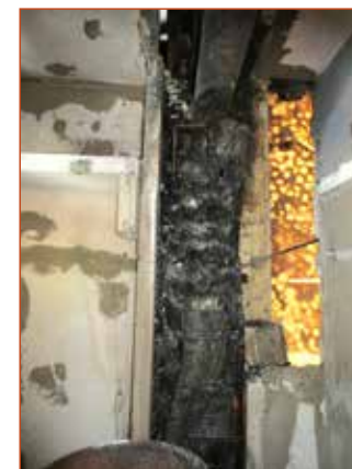
Obr. č. 5 – Pohled na obezděný dřevěný trám – stanovené kriminalistické ohnisko.
