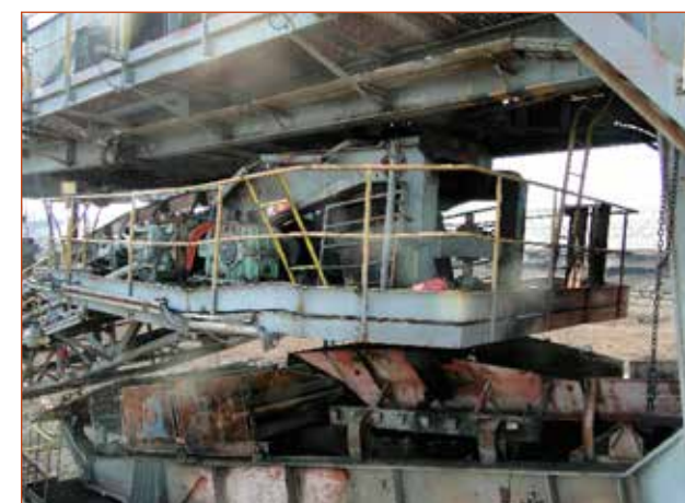
Obr. č. 3 – Místo vzniku požáru – středová násypka.
