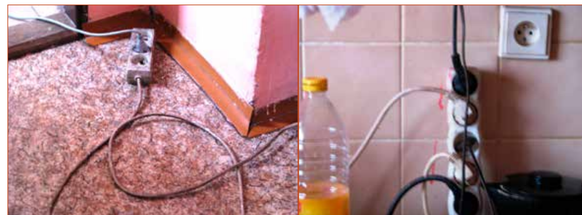
Obr. č. 4 a 5 – Pohled na rozvětvené pohyblivé přívody v bytě ve 3. NP.
