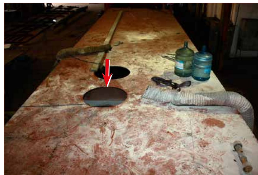
Obr. č. 2 – Vlez a zároveň také výlez pontonu.
