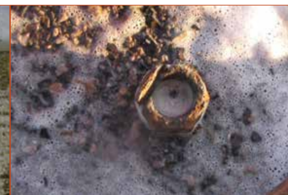
Obr. č. 6 – Pohled na matici demontovanou z armatur (znatelné „nařiznutí ocaskou“).
