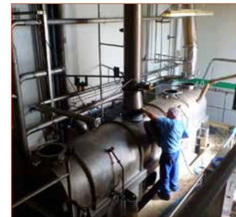
Obr. č. 2 – Pohled na zasaženou technologii.
