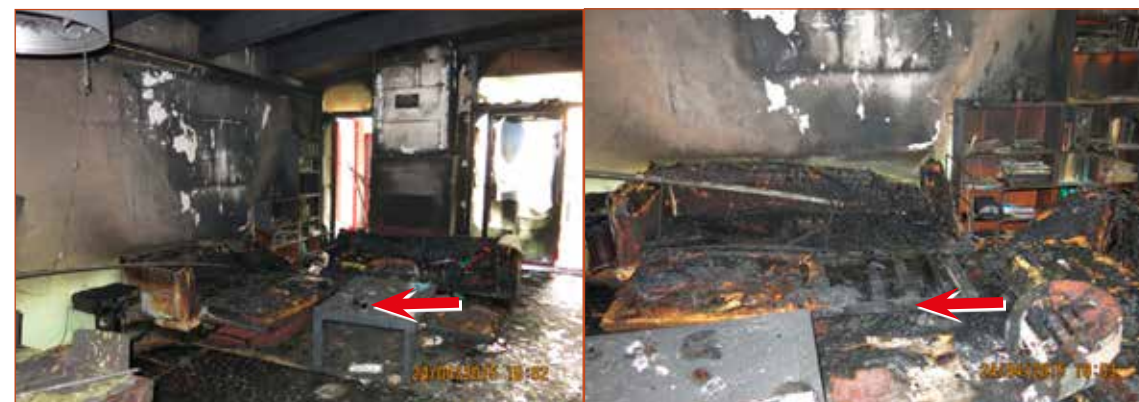
Obr. č. 3 – Bližší pohled na místo, kde došlo ke vzniku požáru.
