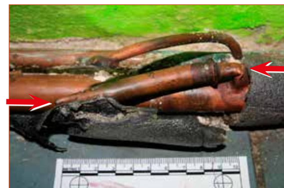
Obr. č. 3 – Místo úniku plynné látky z potrubí.
