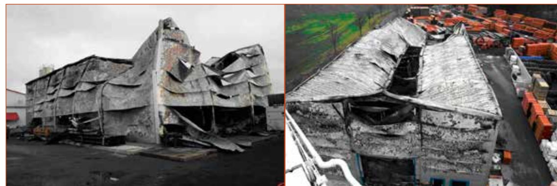
Obr. č. 3 – Pohled na výrobní halu při ohledání.
