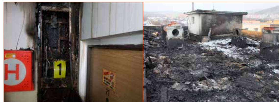
Obr. č. 5 – Pohled na vyhořelý rozvaděč elektroinstalace – kriminalistické ohnisko.
