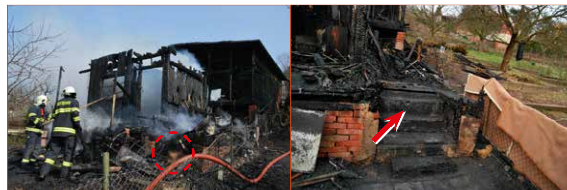
Obr. č. 3 – Pohled na chatu po jejím uhašení (vyznačeno místo nálezu torza lidského těla).
