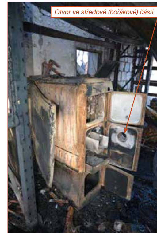
Obr. č. 3 – Celkový pohled na kotel.
