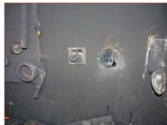
Obr. č. 4 – Zásuvka při ohledání vyšetřovatelem požárů.
