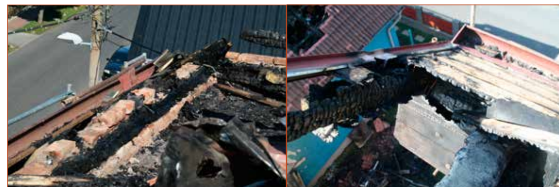
Obr. č. 5 – RD2, konec pozednice u protilehlé štítové zdi. Materiál je vyhořelý do hloubky, vzhledem k umístění pozednice a navazujících konstrukcí, by měla být jednou z nejzachovalejších konstrukcí střechy.
