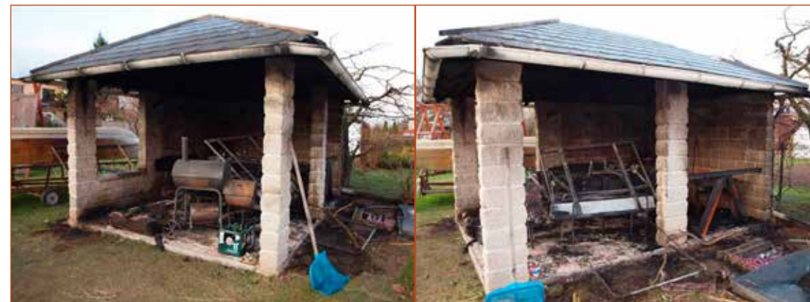
Obr. č. 1 – Celkový pohled na otevřené stěny objektu po požáru.
