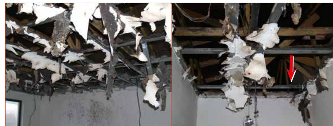
Obr. č. 3 – Celkový pohled na požárem zasaženou stropní konstrukci v kuchyni.
