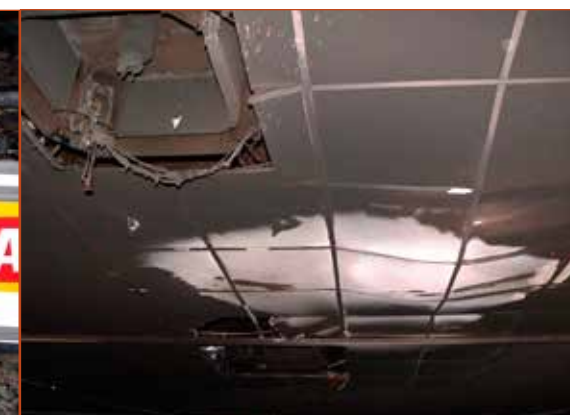
Obr. č. 4 – Pohled na požárem poškozenou ventilační jednotku.
