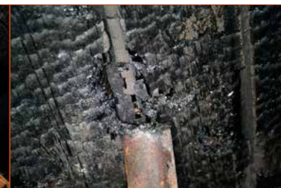
Obr. č. 6 – Degradace materiálu v místě styku trubky a střešní konstrukce.
