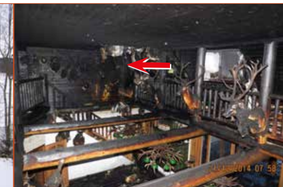
Obr. č. 2 – Svědecké ohnisko požáru.
