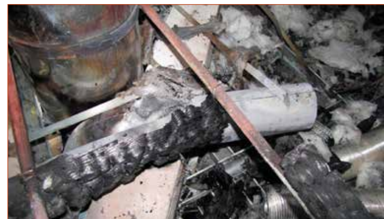
Obr. č. 3 – Detail plechové roury vsunuté do krbové kobky za účelem rozvodu teplého vzduchu v těsné blízkosti dřevěného trámu.
