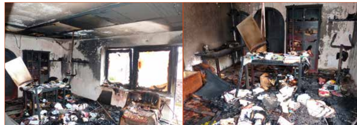
Obr. č. 1 a 2 – Pohled do vnitřního prostoru RD. Obývací pokoj - svědecké a požární ohnisko.
