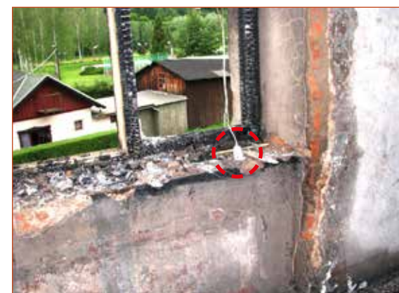
Obr. č. 3 – Pohled na okno, kterým procházel prodlužovací kabel z bytu v 2. NP, červeně vyznačena vidlice prodlužovacího kabelu.
