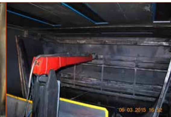
Obr. č. 6 – Automatická lakovací linka - duální pracoviště nezasažené požárem.
