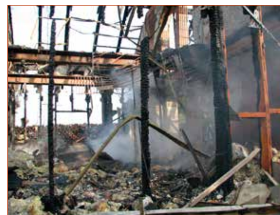
Obr. č. 3 – Pohled na zbytky konstrukce rodinného domu v 1. NP – obývací.
