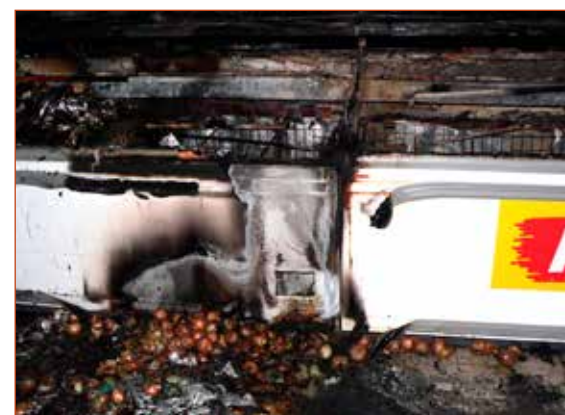
Obr. č. 3 – Celkový pohled na požární a kriminalistické ohnisko.
