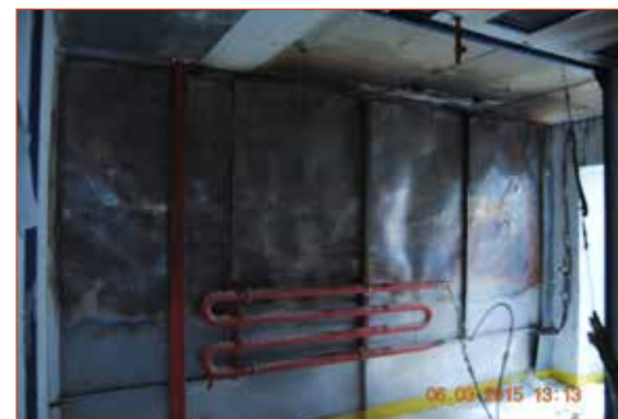
Obr. č. 3 – Vyžíhané kovové opláštění lakovny pohled z vnější strany.
