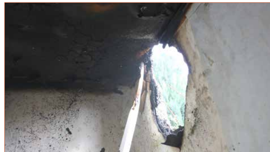
Obr. č. 4 – Vyhořelá vnitřní konstrukce domu po demontáži zateplovacího systému.
