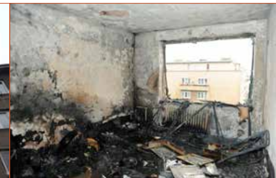
Obr. č. 2 – Místnost, ve které vznikl požár.
