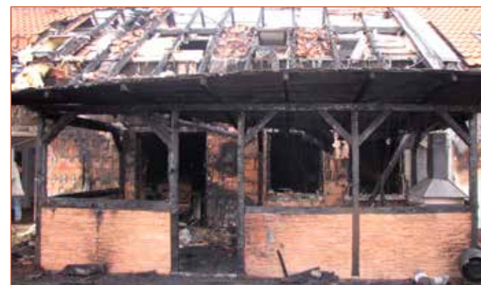
Obr. č. 3 – Vpravo instalovaný krb bez vyvedení komínu nad střechu.
