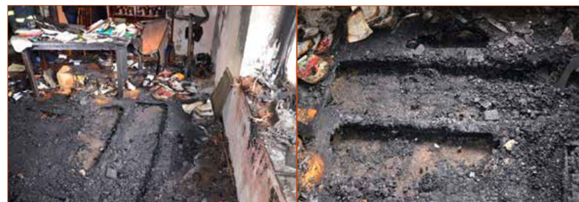
Obr. č. 3 a 4 – Pohled na poškozenou dřevěnou podlahu obývacího pokoje. Poškození bylo způsobeno hořením sedací soupravy – značného množství molitanu.
