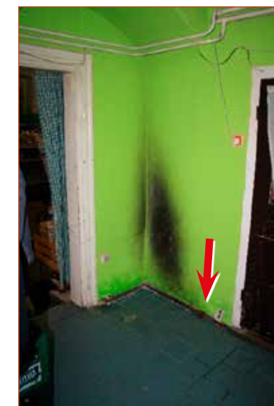
Obr. č. 4 – Místo požáru – kancelář.
