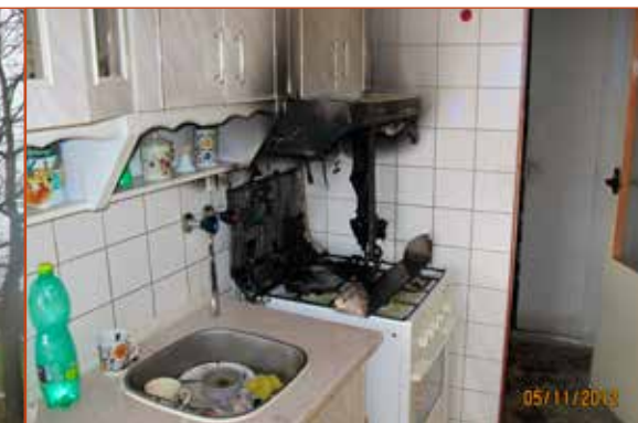
Obr. č. 2 – Pohled z prostoru kuchyně na kombinovaný sporák a odsávací digestoř umístěné vlevo od dveří za kuchyňskou linkou - kriminalistické ohnisko.
