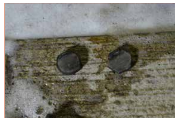
Obr. č. 5 – Pohled na šrouby oddělené úhlovou bruskou (šrouby nalezeny uvnitř šachty po opadnutí hasební pěny).
