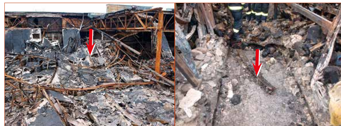
Obr. č. 5 – Místo vzniku požáru.
