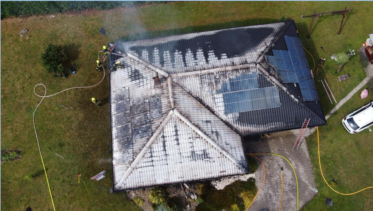
Obrázek 1: Požár střešní konstrukce způsobený FVE (zdroj: fotodokumentace HZS ČR)
