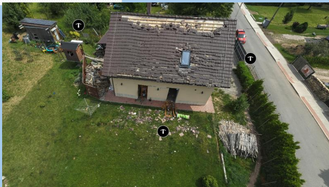
Obrázek 7: Přetlakové účiny na objektu způsobené explozí baterie (zdroj: fotodokumentace HZS ČR)
