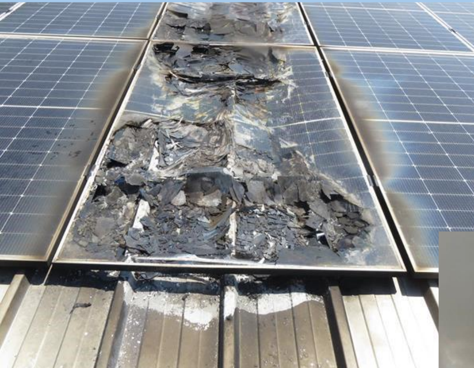
Obrázek 4: Požár FVE u nehořlavé střešní konstrukce – šíření zastaveno
