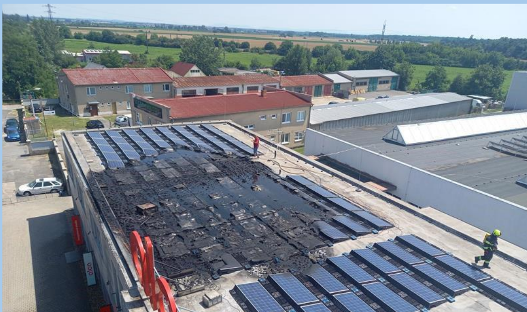
Obrázek 3: Požár FVE u hořlavé střešní konstrukce – šíření nezastaveno
